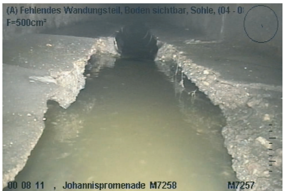
Ausspülungen an der Fließsohle
